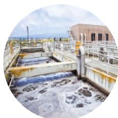
Ścieki / oczyszczanie Zagęszczanie osadów
